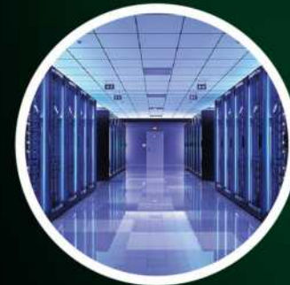
телекоммуникационное оборудование и ЦОД
